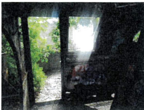
Lewa strona budki maszynisty, drzwi zostały wyrwane z zawiasów
