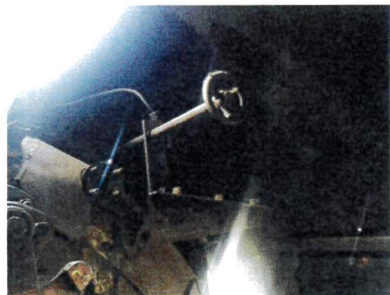
Sztyca zaworu sprężarki, pusta podstawa manometrów hamulcowych, miejsce po głowicy prawego wodowskazu.
