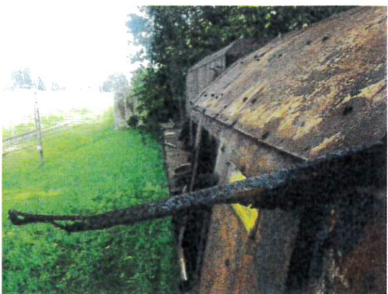
Zniszczona rynny dachu
