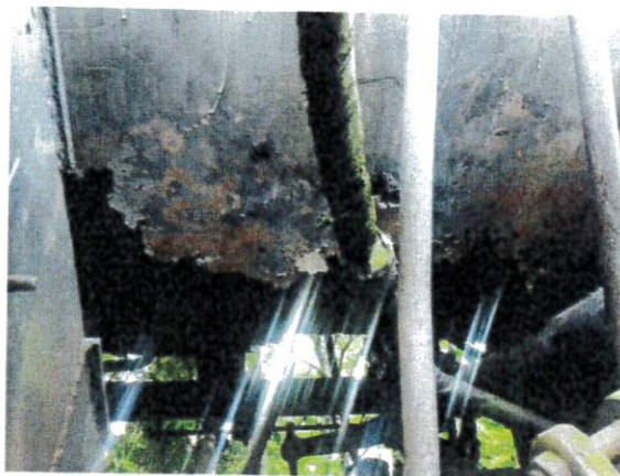
Skorodowana otulina kotła pod pierwszym (przednim) dzwonem walczaka
