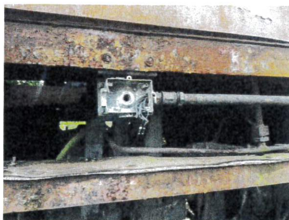
Zniszczona skrzynka rozdzielcza
