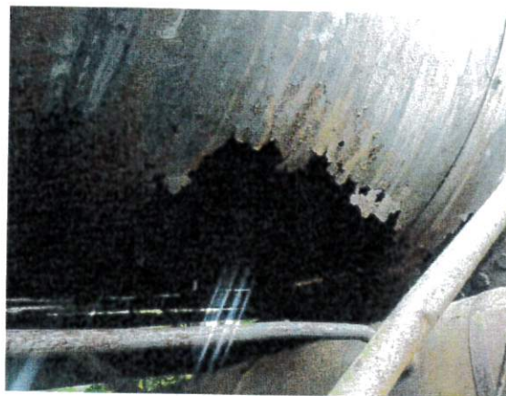
Zniszczona blacha otuliny pod drugim (tylnym) dzwonem walczaka
