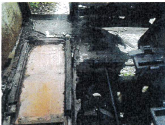
Kompletnie zniszczona podłoga, po lewej leżą wyrwane drzwi
