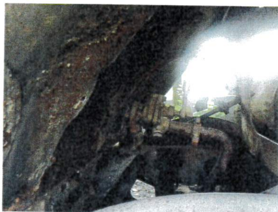
Zniszczona otulina na ścianie podgardlanej stojaka obok tylnego odmulacza
