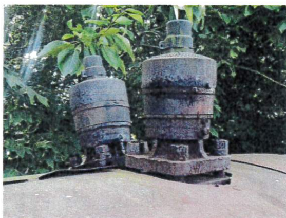
Zawory bezpieczeństwa na kotle
