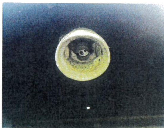
Zniszczona oprawka lampy korbwodowej
