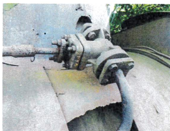
Zawór zasilający sprężarki
