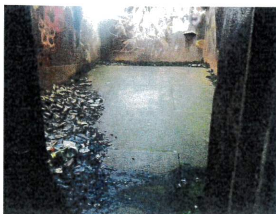
Wnętrze skrzyni węglowej.
