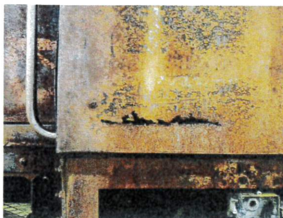
Skorodowane ściany zewnętrzne, brak malatury
