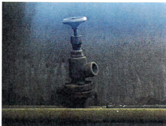
Króciec przeciwpożarowy na rurach zasilających
