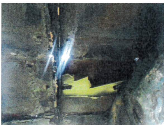
Zniszczony przez korozję dach budki maszynisty
