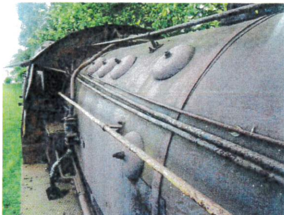
Otulina kotła w górnej części stojaka
