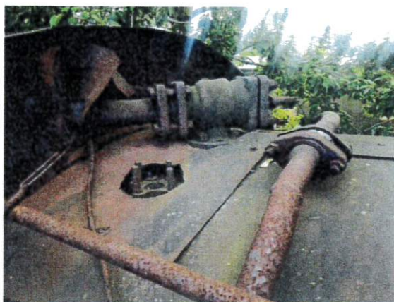
Główny zawór parowy, widoczne miejsce po zdemontowanej gwizdawce
