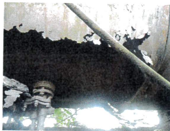
Zniszczona przez korozję blacha otuliny przy przednim odmulaczu
