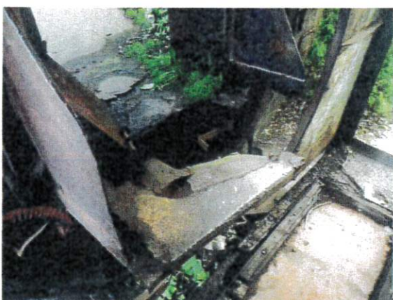
Zniszczona półka podajnika węgla
